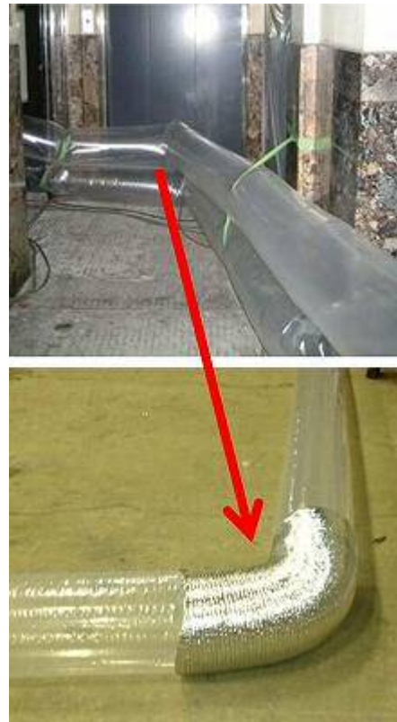
図-14 ビニールダクトの曲がり部分に環状の支え（アルミ製ダクト）をビニールダクトに重ねて使用した例
