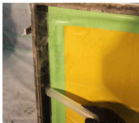
写真Ⅶ-2 HEPA フィルタ周辺部分
