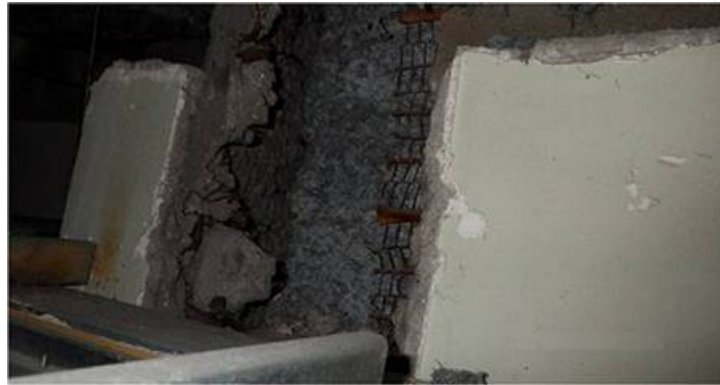
写真Ⅱ-13 壁の中に青石綿が吹かれラス網の上モルタル+プaster塗り仕上げ
