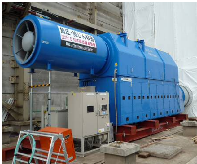
写真Ⅸ－1 大型集じん・排気装置の例（定格風量1,800m 3 /分）
