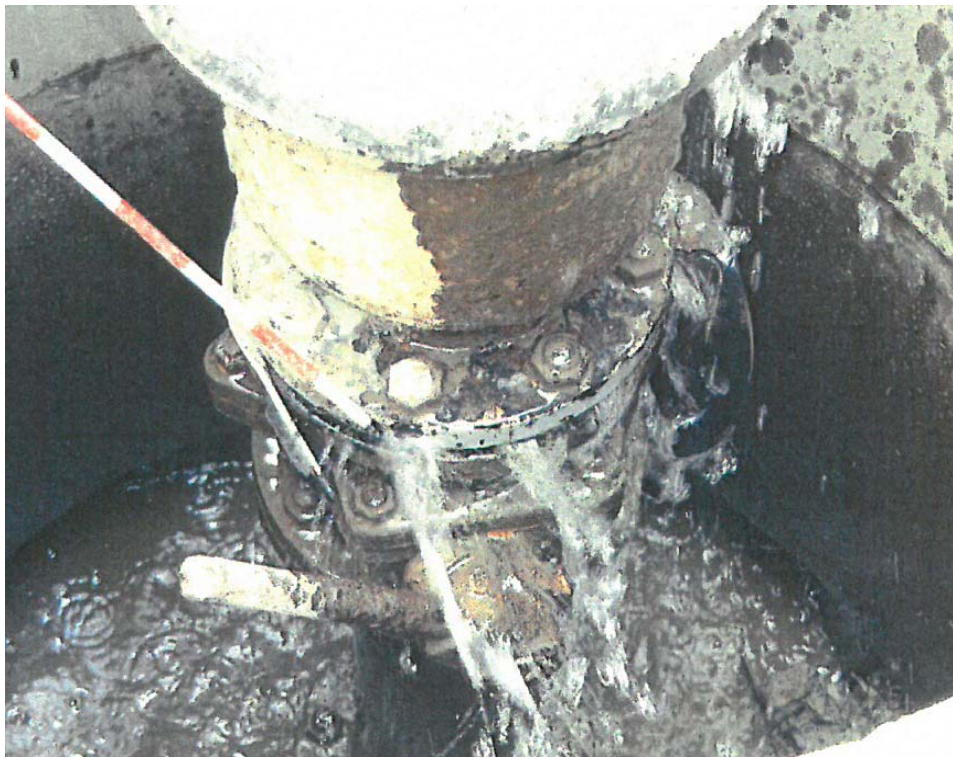
写真 5.2.13 空気弁フランジ部の漏水(東区秋津町沼山津, 付属 No. 94)
