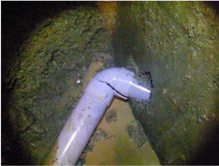
写真 5.2.12 φ125 塩化ビニル管の管体破損(東区上沼山津橋右岸)
