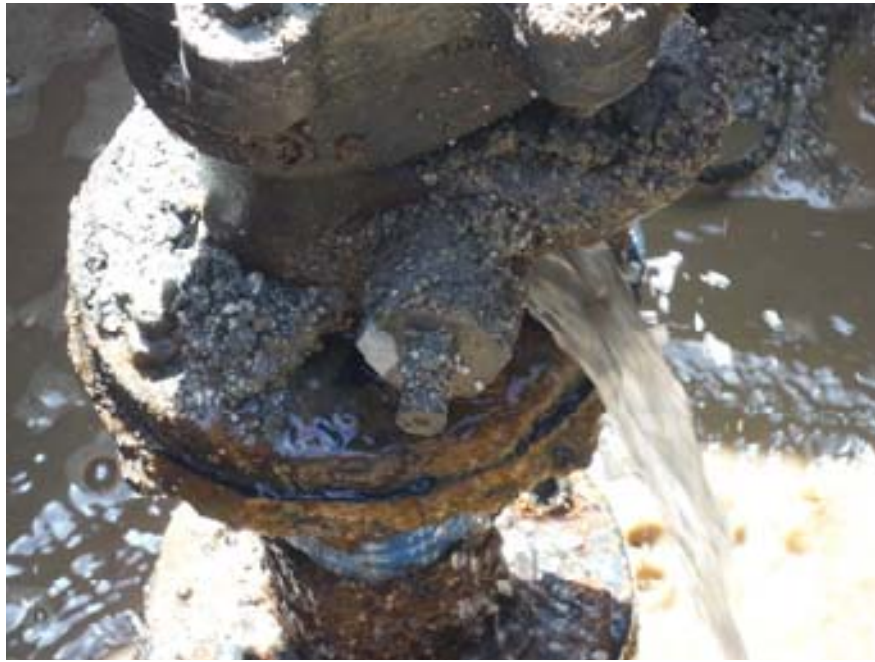
写真 5.2.16 \phi 150 \times 75 消火栓破損（上沼山津付近，付属 No. 8）
