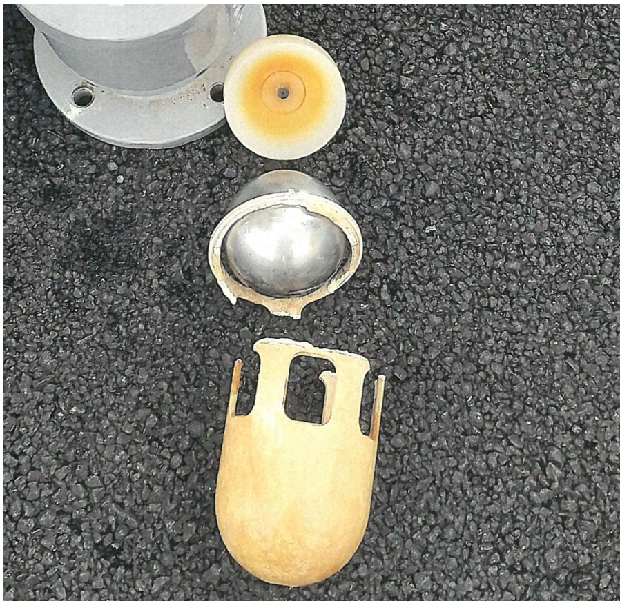
写真 5.2.19 空気弁（案内内部）破損（南区出仲間 9 丁目，付属 No. 115）
