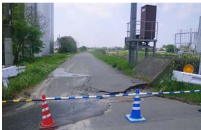
右岸の不同沈下
