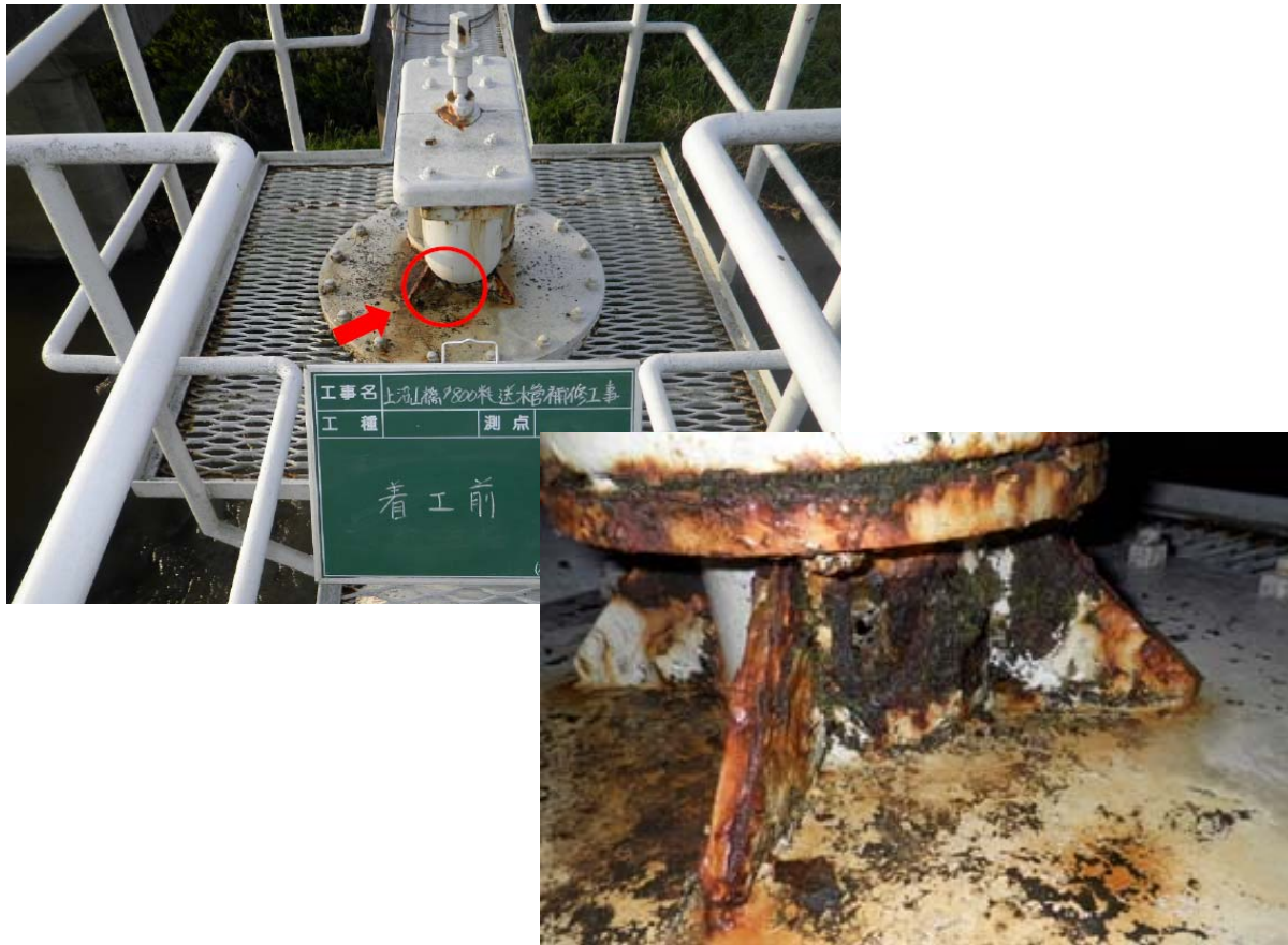
写真 5. 2. 4 φ800 鋼管空気弁用フランジ管の腐食（東区上沼山津橋, 水管橋付属 No. 17）
