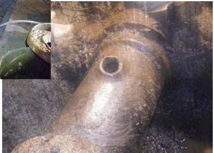
写真 5.2.17 \phi 350 \times \phi 75 鋳鉄管の消火栓漏水（東区沼山津 4，配水 No. 36）
