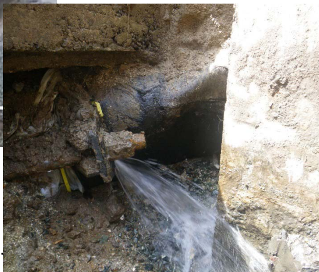
写真 5. 2. 1 \phi 800 鋼管(溶接)の管体破損 (東区上沼山津橋右岸, 導・送水 No. 12)
