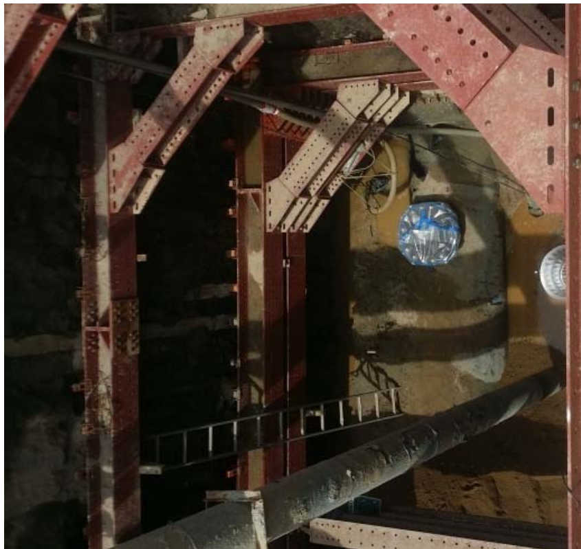
写真 5.2.7 \phi 1350 鋼管(溶接) 人孔管フランジ部補修状況 (東区画図町下無田, 同上)
