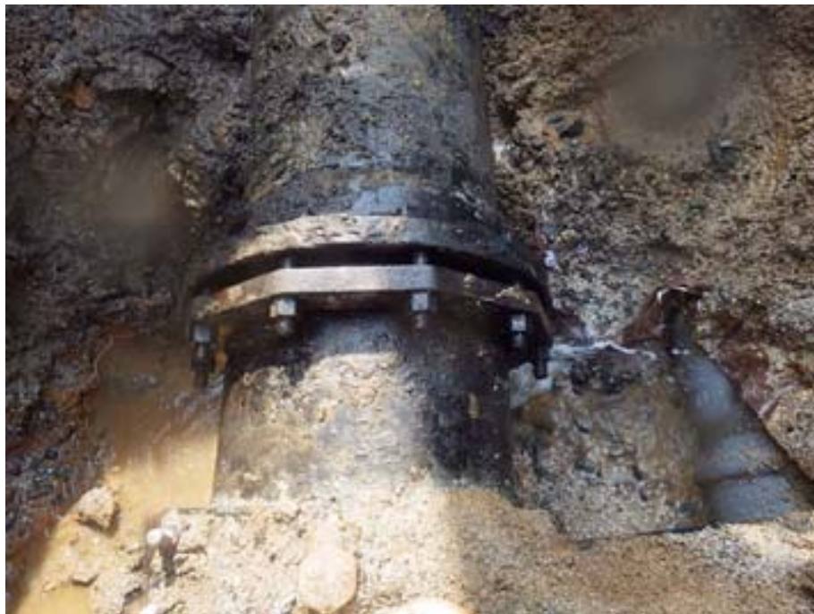
写真 5.2.9 \phi 350 鑄鉄管 (A 形) 抜け出し (東区沼山津 3, 配水 No. 34)
