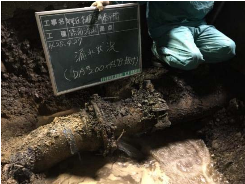
写真 5.2.10 φ200 ダクティル鉄管 (A形) 抜け出し (中央区紺屋阿弥陀寺町, 配水 No. 89)
