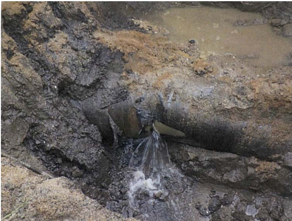
写真 5. 2. 5 φ800 鋼管溶接部破損（東区秋津町沼山津, 導・送水 No. 12）
