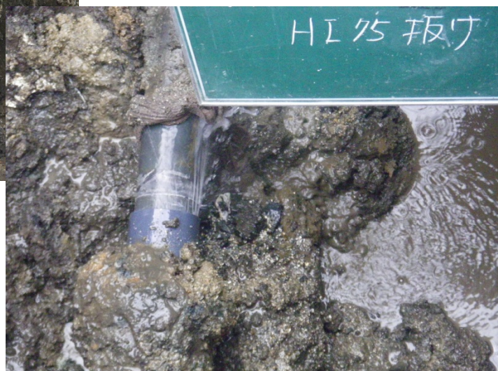
写真 5.2.11 φ75 塩化ビニル管 抜け(東区秋津2丁目, 配水 No. 214)
