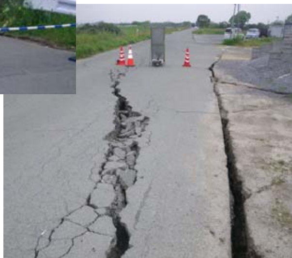
左岸の地割れ
