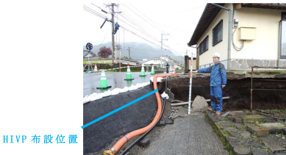
写真 5.4.1 断層横断部での HIVP φ 100 被害 (阿蘇市狩尾県道 175 付近)
