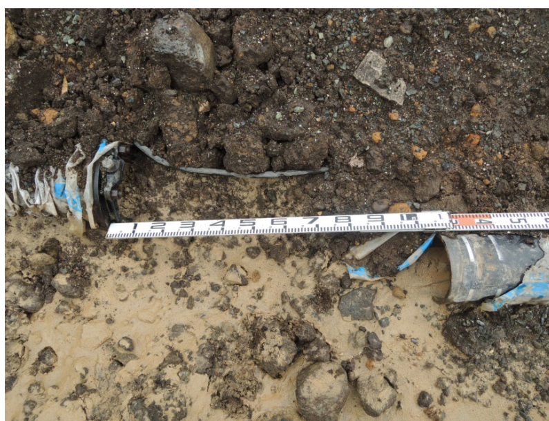
写真 5.6.2 同 DIP A 形 \phi 200 抜け被害状況
