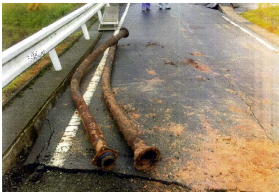
写真 5.3.2 断層横断部の DIP K 形 \phi 100 2 条配管抜け (益城町下陣 700 付近)
