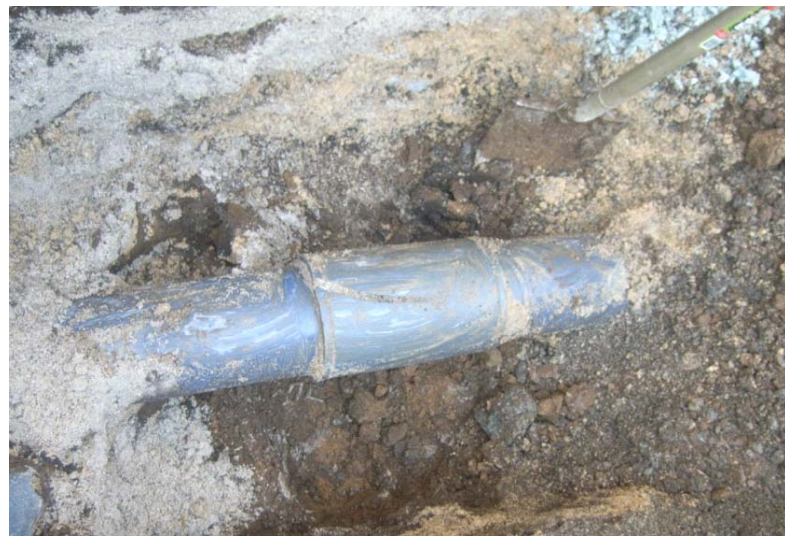
写真 5. 6. 4 VP TS 継手 φ150 被害状況
