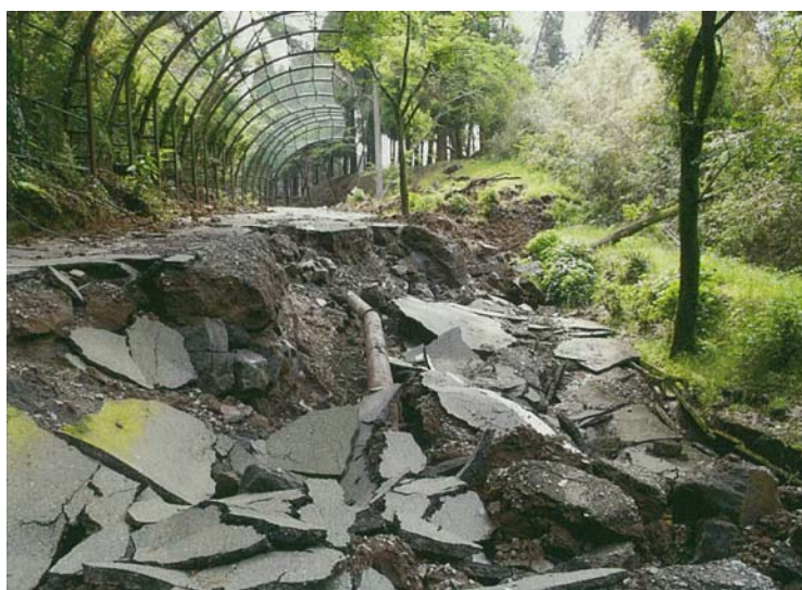
写真 5.5.3 第 2 配水池～第 3 配水池送水管被害 (管種不明)
