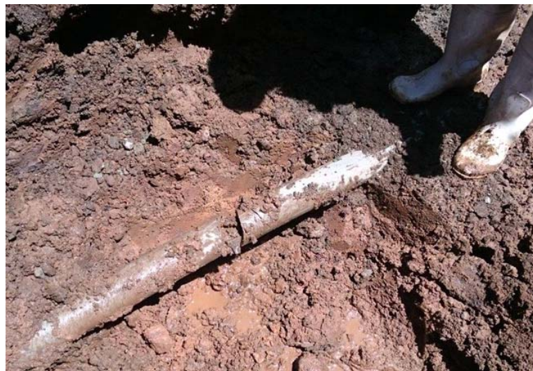
写真 5. 6. 5 VP TS 継手 φ75 管体被害状況
