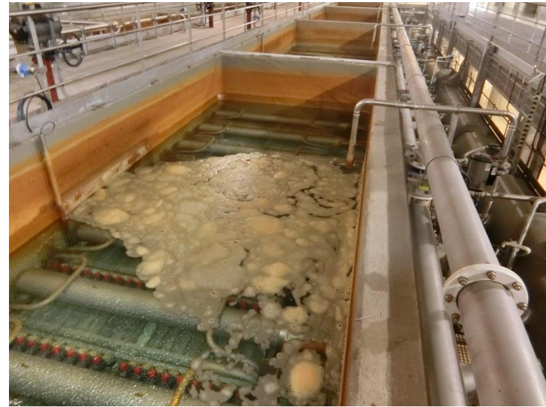
【限界ろ過膜を利用した浄水施設】
