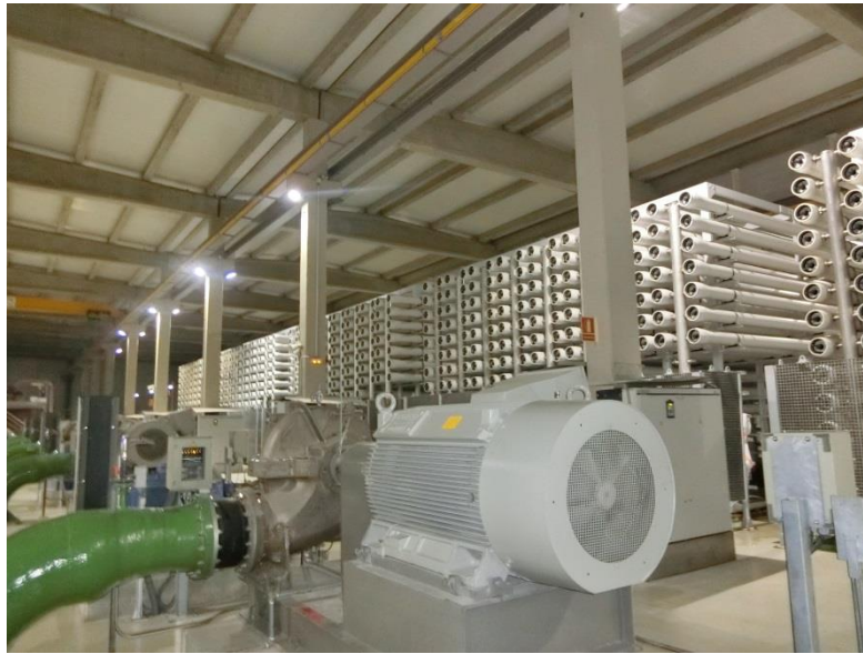
【逆浸透膜を利用した浄水施設】
