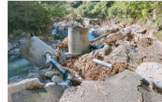
丸森町石羽浄水場の取水口流出
