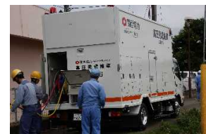
電源車の配備
