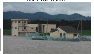
河川氾濫で浸水した取水井戸 (山形県雄花沢市)
