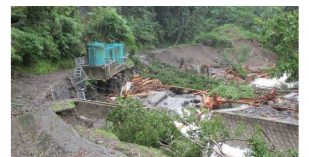
土砂崩れ等で破損した取水施設 (熊本県八代市)
