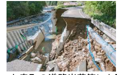
丸森町の道路崩落等によるアクセス路(県道)被災
