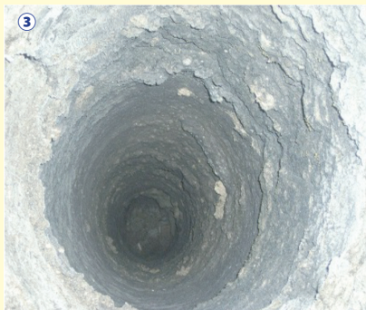
③ 表層剥離、欠損、垂れ、毛羽立ち等がある。
