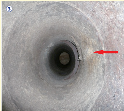
③ 部分的に下地から浮き、膨れがある。
