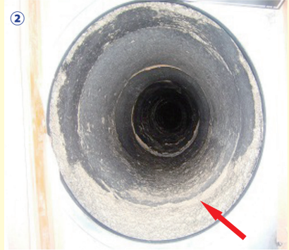
② 頂部に雨水等による侵食がある。
