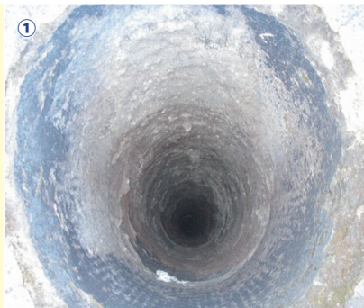
① 表層剥離、毛羽立ち等がある。
