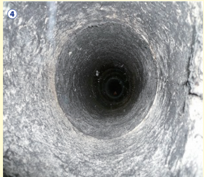
④ 毛羽立ち、繊維の崩れがある。
