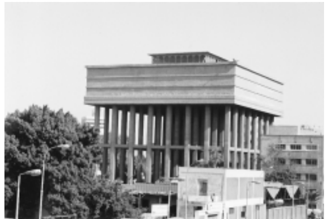
写真7 地震で壊れそうな配水池（使われていない）
