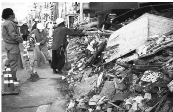
(2)防護マスクをしない作業者と吹付けアスベストの粉じんの清掃
