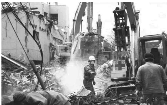
(1)散水も行われない解体工事
