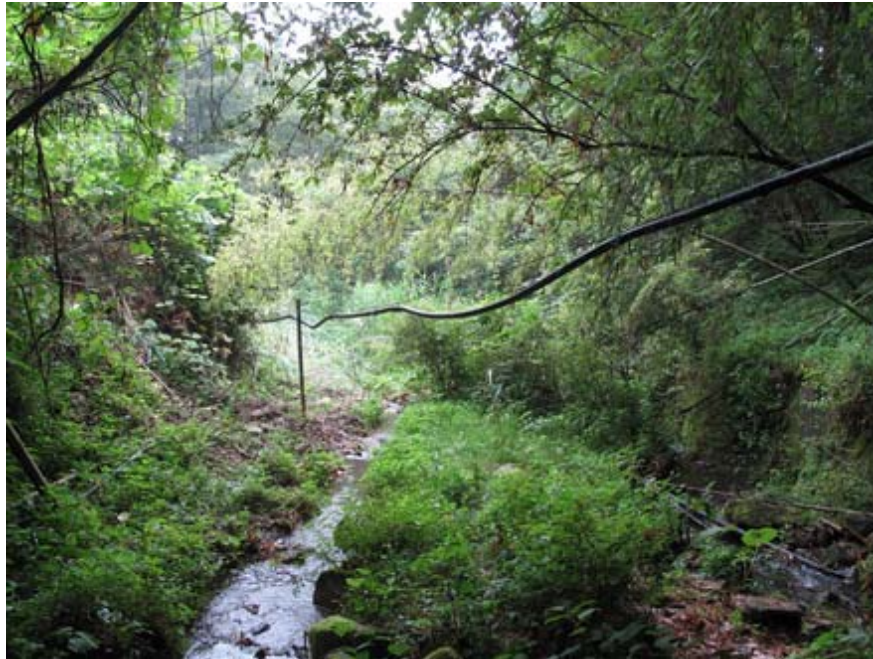
浄水施設までの導水管 (砂防堰堤から取水)
