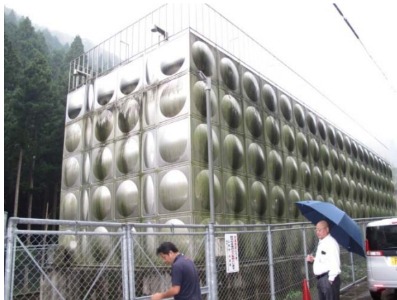
k旧簡水の浄水施設
