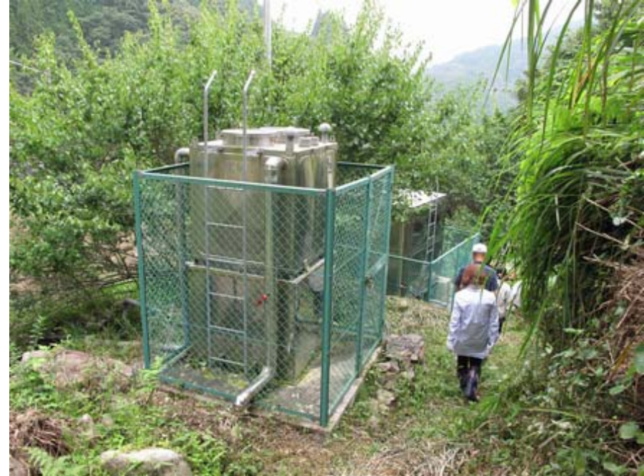
沈砂池と配水池 沈砂池には塩素注入設備有 (使用されていない)
