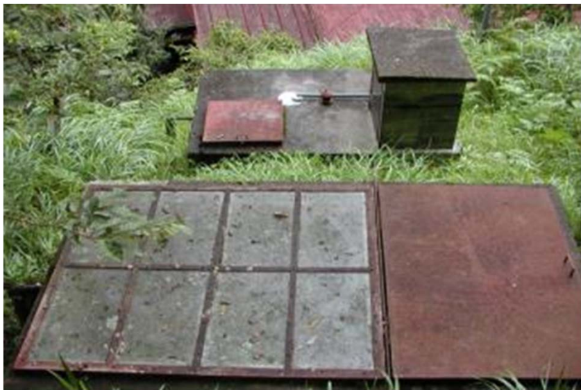
一般的な緩速ろ過池
