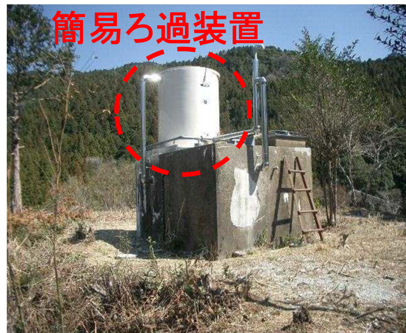
配水池天端に設置した 簡易ろ過装置
