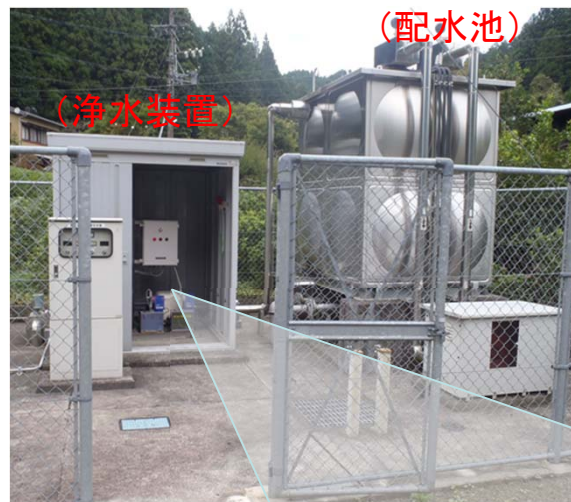
沢水専用浄水装置
