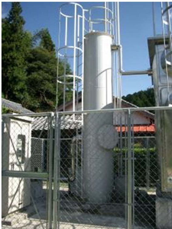
円筒形 急速ろ過池
