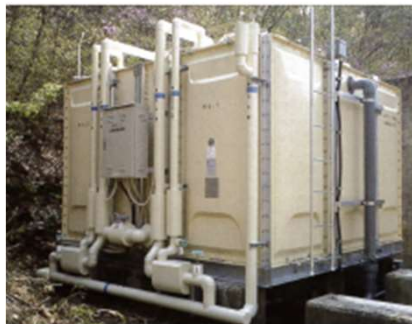
無動力式除砂装置 + 原水槽
