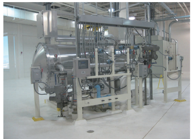
写真 20 同浄水場オゾン発生装置
