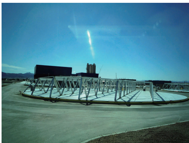
写真 27 クラーク郡水再生地区中央処理場初沈
